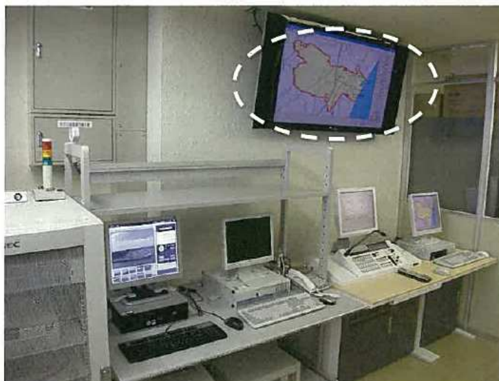
図3-14 NEC/NECネットエスアイ『東日本大震災第三者検証委員会ご質問に関する回答』名取市様操作室の写真
