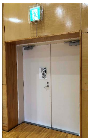
ホールの搬入口 子扉のロックも忘れずに
