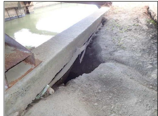
境堀排水路:劣化状況(背面土吸出し)
