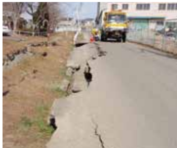
● 飯野坂地区の道路被害の様子
