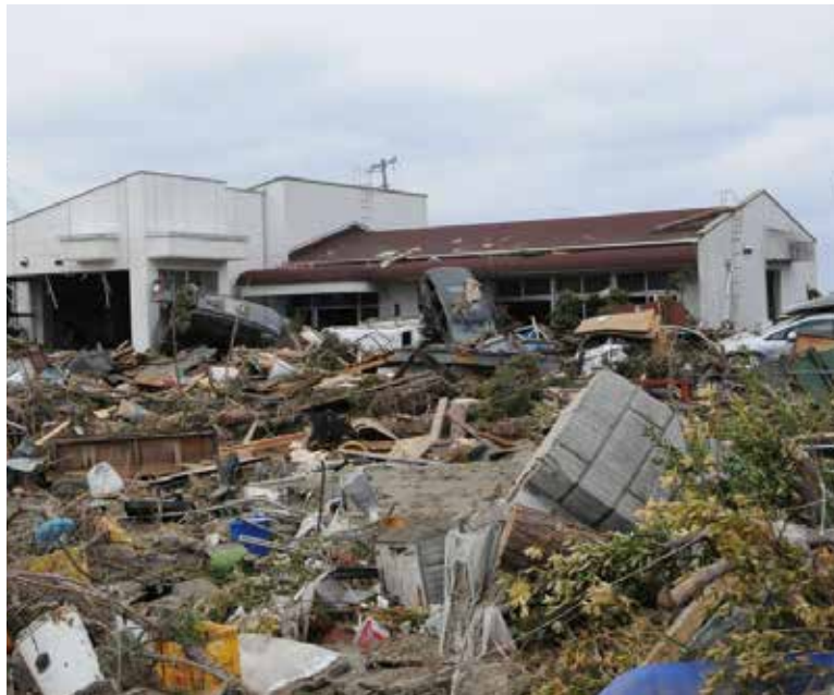
● 津波被害を受けた北釜集会所
