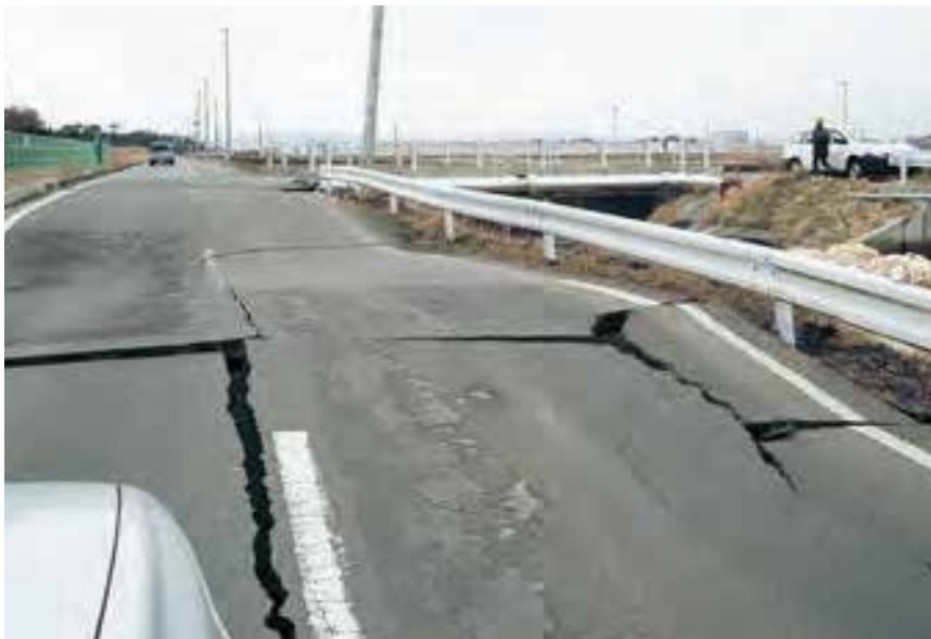
● 下増田・仙台空港付近の道路の亀裂
