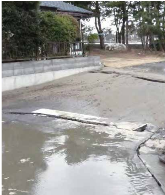
● 関上5丁目の液状化現象[提供: ㈱ささ圭]
