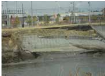
● 土手の一部が崩壊した増田川堤防
