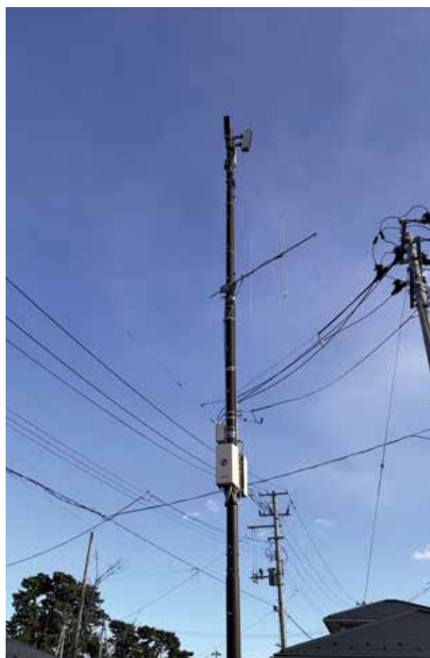
移設された防災行政無線（閑上西一丁目）
