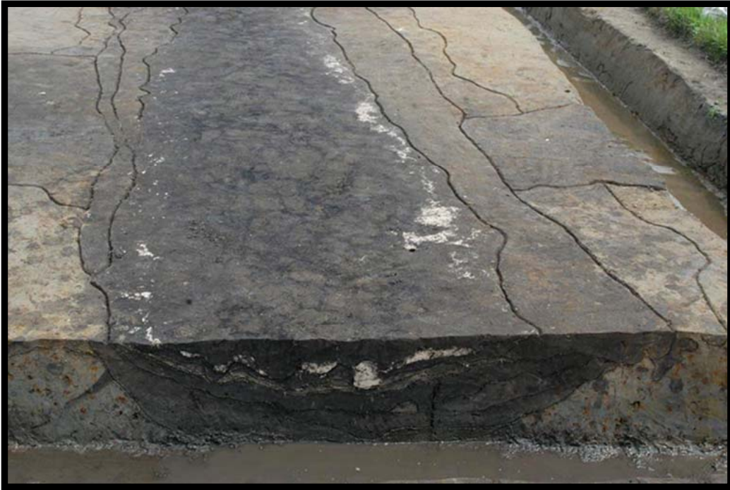
水路に溜まった土の様子
