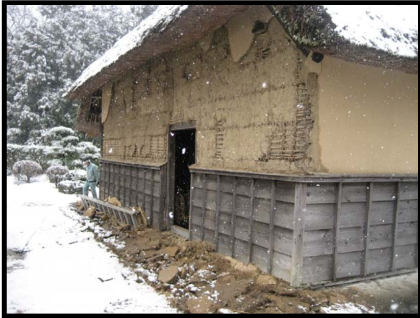
震災直後の外壁の状況
