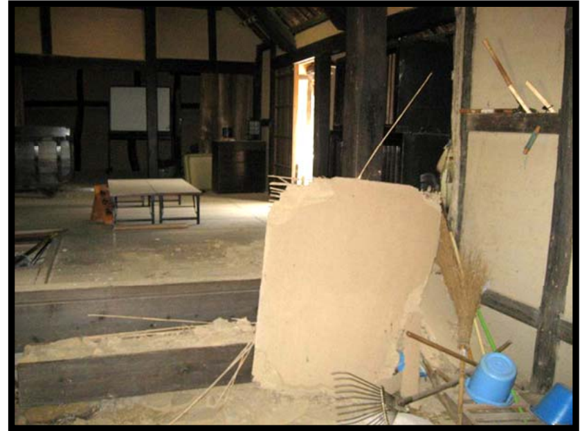
震災直後の内部の状況
