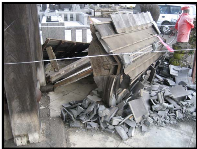
倒壊した袖塀（そでべい）
