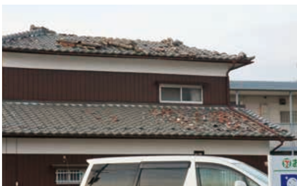
屋根瓦倒壊状況（名取市）
