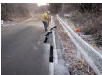
路肩の崩壊(名取市)
