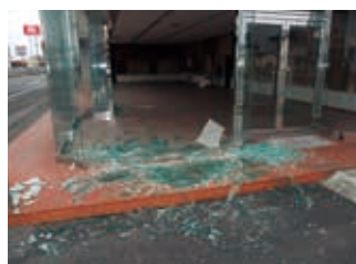
ガラスが 割れた状況 (名取市)
