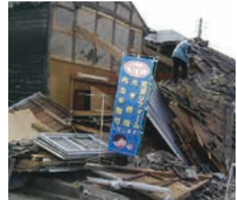
激しい揺れによる 建物の倒壊
