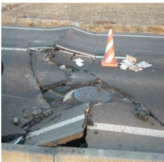
地震により段差ができた道路
