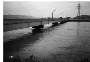
8.5 豪雨による被害状況（宮城県）
