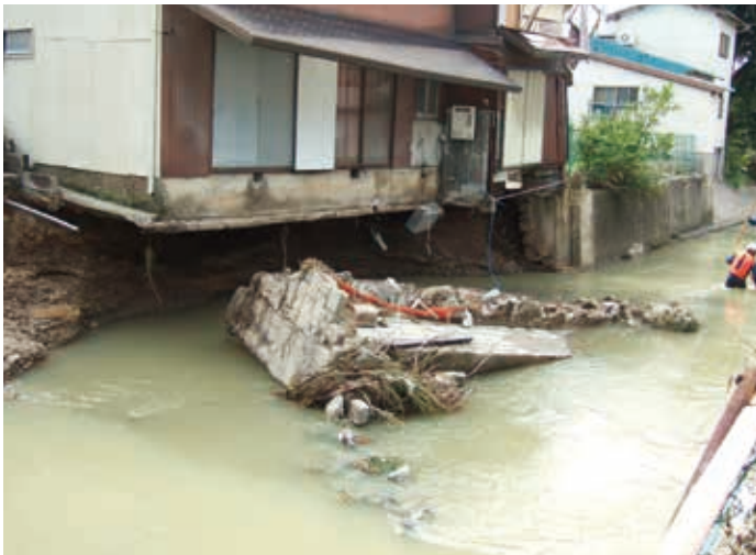
豪雨による家屋の被害状況
