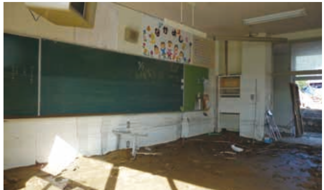
平成 23 年台風 12 号による被害状況 (和歌山県那智勝浦町)
