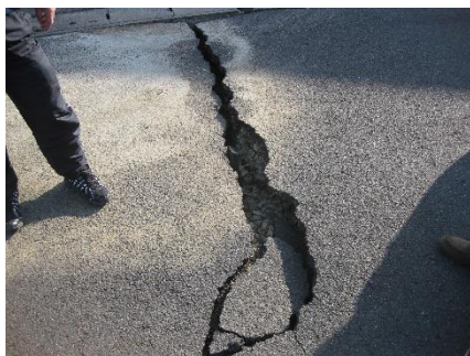
東日本大震災の道路の段差
