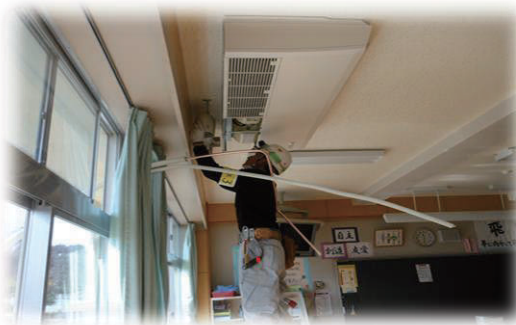
▲すべての普通教室に空調設備を設置
