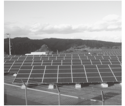
▲愛島台メガソーラー発電所
