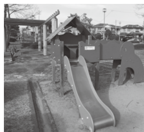
▲老朽化により平成27年度での更新が予定されるなかよし公園(相互台)の遊具
