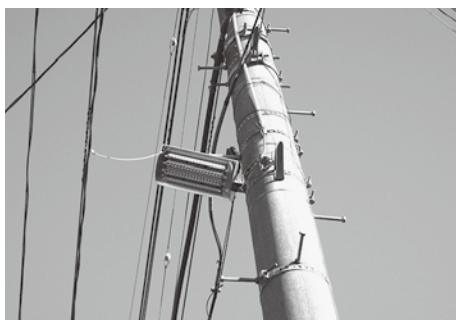
▲市内に設置されているLED街路灯
