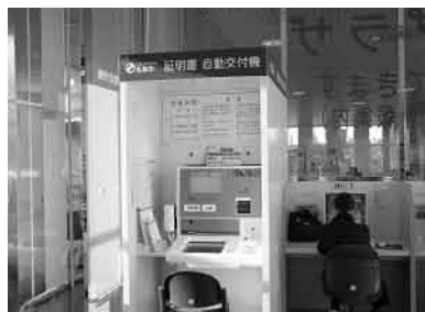
▲名取駅コミュニティプラザに設置されている証明書自動交付機
