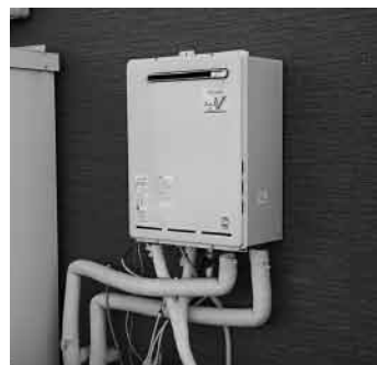
▶仮設住宅に設置された追いだき機能のついた給湯器
