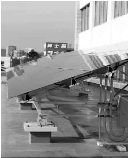
▲ 市役所正面玄関上に設置されている太陽光パネル
