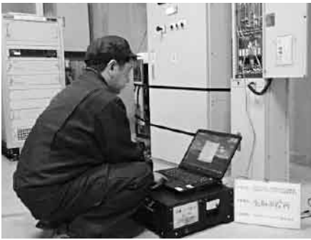
▶防災行政無線の保守点検
