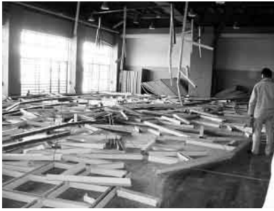
▲天井材が落下した市民体育館柔剣道場
