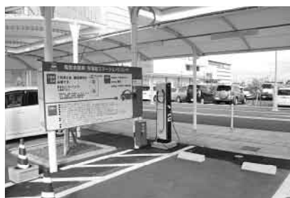
▲イオンモール名取内に設置された電気自動車充電施設
