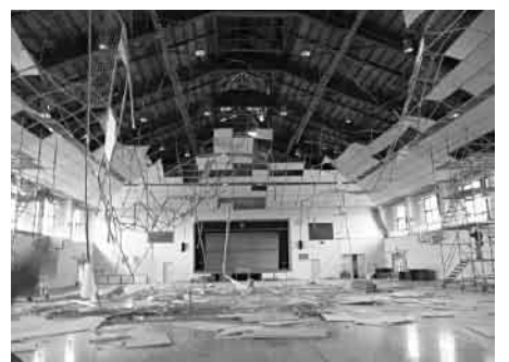
▶天井材落下の被害例
