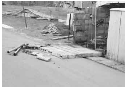
▲ 震災で倒壊したブロック塀
