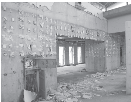
▶ 震災で大きな被害を受けた斎場内部の様子
