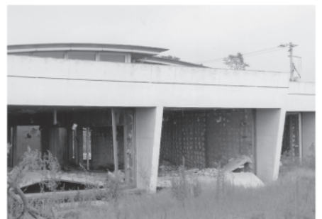
▲壊滅的な被害を受けた斎場
