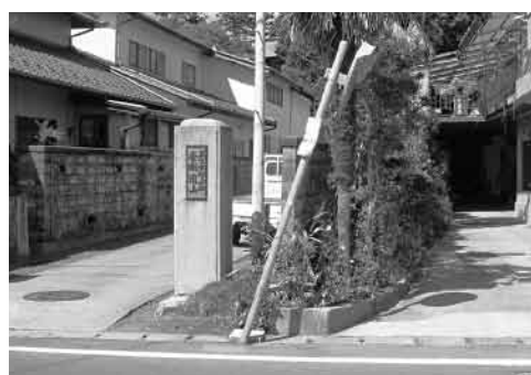
▶当て逃げで破損したカーブミラー
