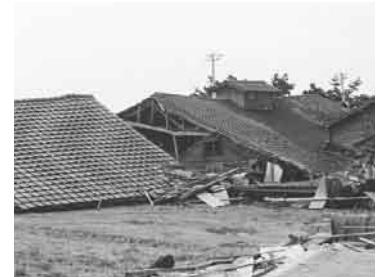
▲ 昭和53年の宮城県沖地震による市内の建物被害
