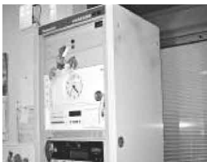
▶緊急地震速報設置例
