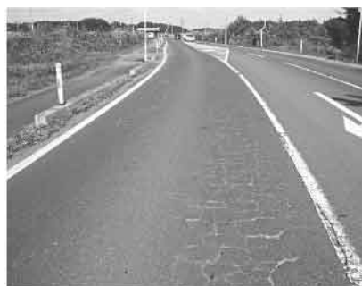
▲損傷がみられる農道下増田16号線
