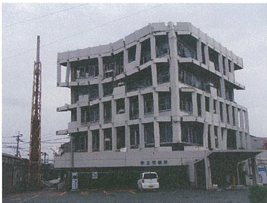
図1 倒壊寸前の宇土市役所庁舎
