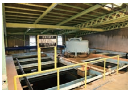
高速凝集沈殿地
