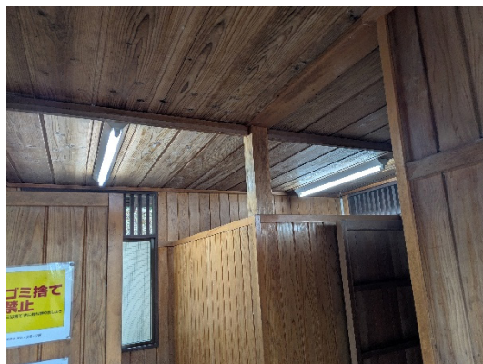
写真 65 トイレ内の照明設備
