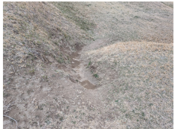
写真 45 雷神山古墳くびれ部の傷み
