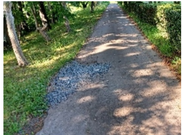
写真 41 はがれた舗装
